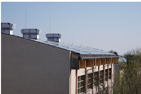
Zdjęcie Nr 4 – Instalacja fotowoltaiczna na obiekcie OSiR w Sędziszowie
