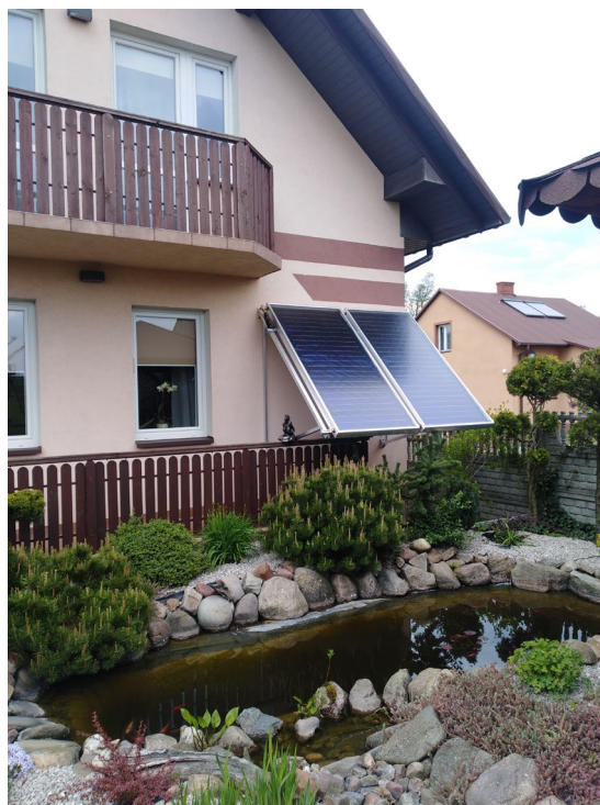
Zdjęcie Nr 5 – Instalacja kolektorów słonecznych
